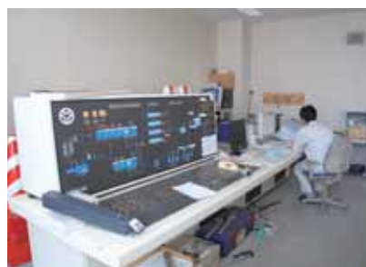
▲池田浄水場管理棟内にある総合監視室。町内全域の水道施設について、取水から配水までの動きを常時監視しています。
